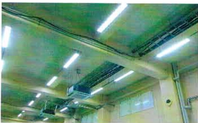
蛍光灯からLEDに付け替えられた工場内の照明
