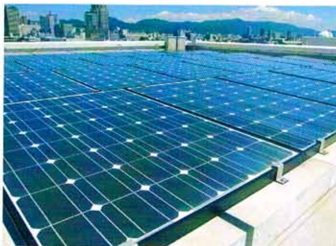
屋上に敷き詰められた太陽光パネル
