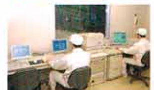
サイロコントロール室 (西宮浜玄米サイロ) 入出荷作業はもちろん、在庫管理、品質管理などすべてコンピュータでチェックしています。
