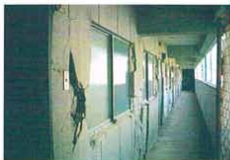
崩れそうな壁面が震災の恐ろしさを物語る
